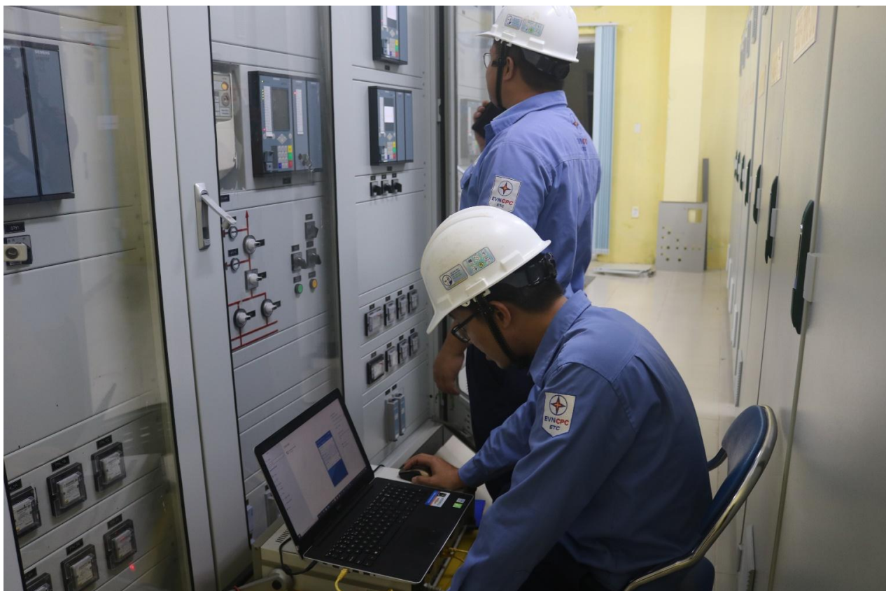
Thí nghiệm đưa vào vận hành TBA 220kV – NMĐMT Phù Mỹ 1-2-3 (2020)
