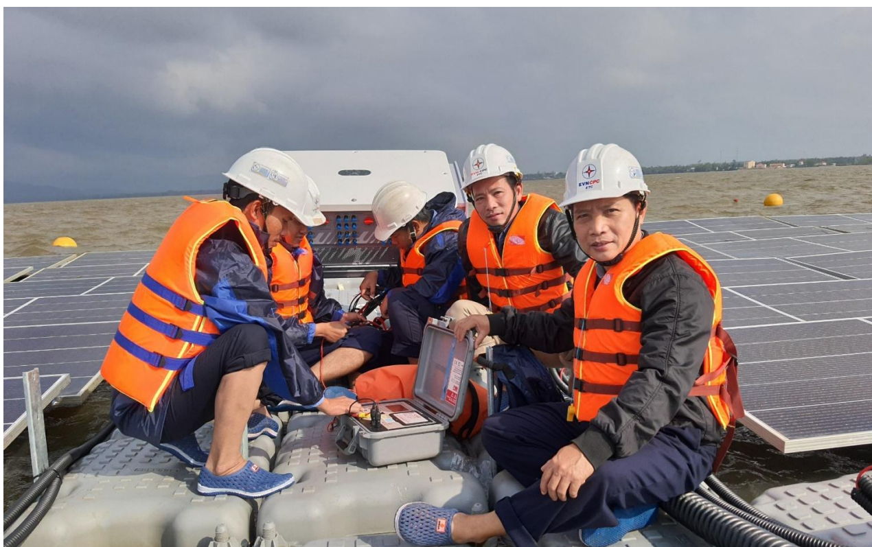
Thí nghiệm đưa vào vận hành NMĐMT Đầm Trà Ô (2020)
