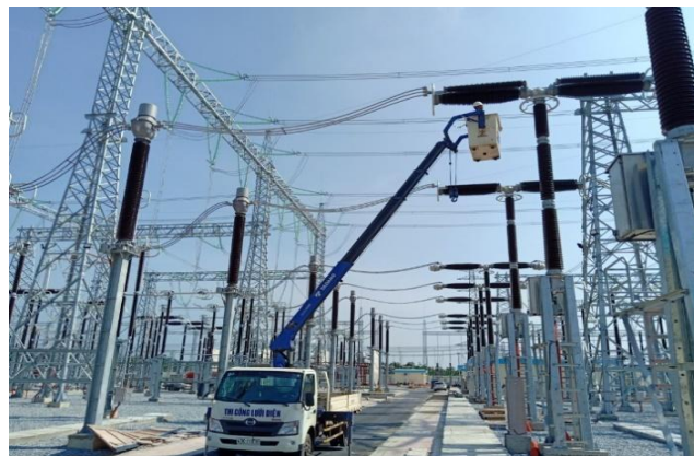
Thí nghiệm đưa vào vận hành tại TBA 500kV Chơn Thành
